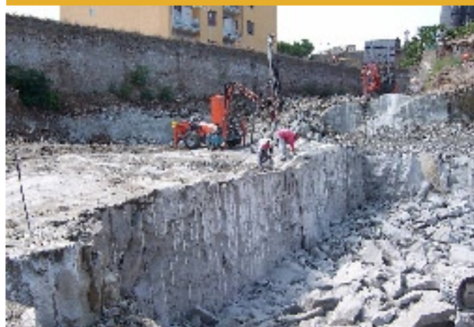
Tagli e rotture eseguiti con la malta
